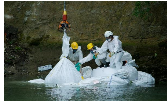
Déchets et dépollution
